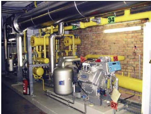
Maschinenraum mit WP
