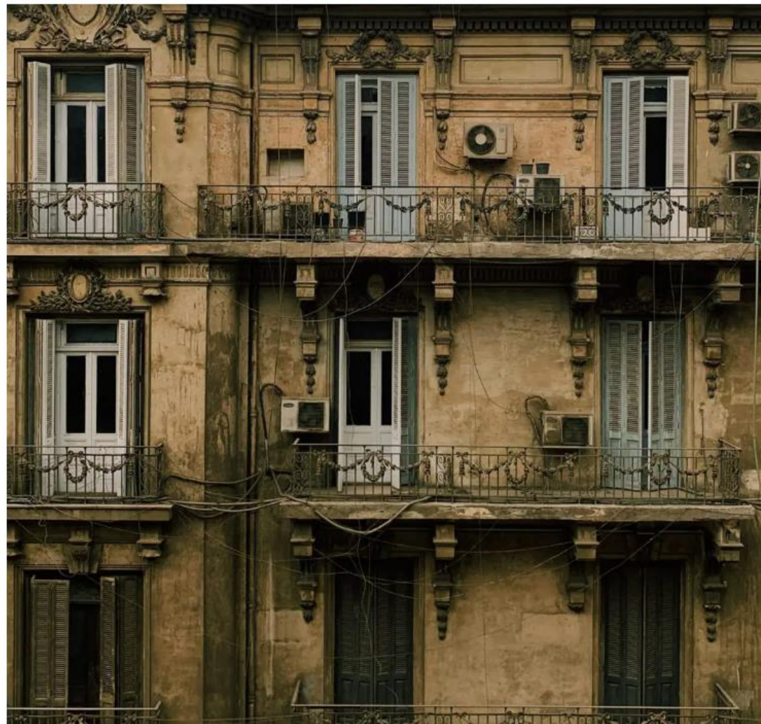
Einzelne Klimageräte an der Fassade eines Bestandsgebäudes
